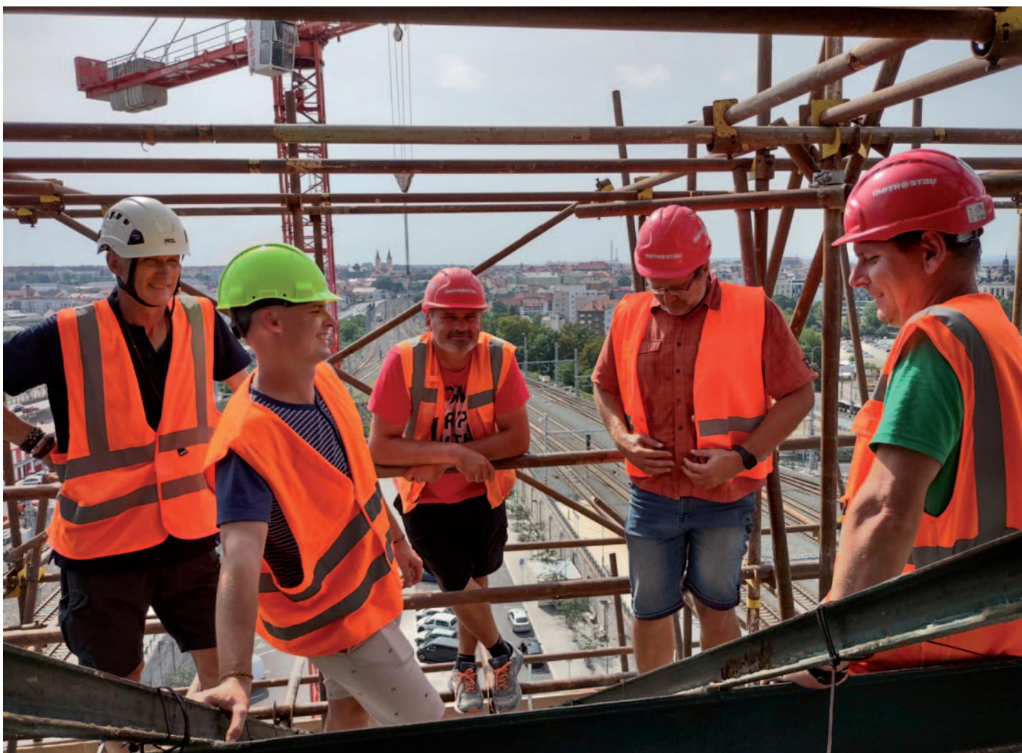
Místní šetření na lucerně kupole: zleva Ing. Petr Bílek, externí dozor, Kloknerův ústav ČVUT - Jaroslav Soumar, HIP, SUDOP PRAHA - Ing. Tomáš Lavička, hlavní stavbyvedoucí, Metrostav - Ing. David Chmelík, statik, Statica Plzeň - Ing. Miroslav Kšíř, ředitel stavby, Metrostav. Foto Ing. arch. Jiří Mašek, architekt stavby a odpovědný projektant, SUDOP PRAHA.
