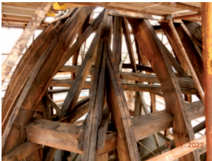
Krov boční věžičky po odbednění, který je narozdíl od krovu hlavní kupole v dobrém stavu.
