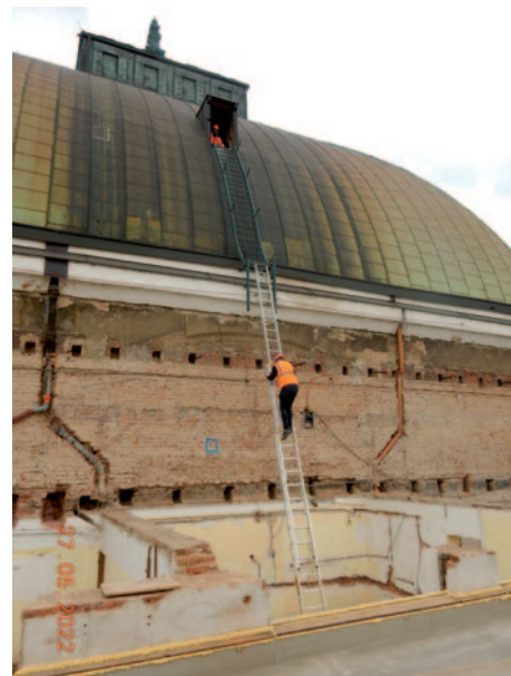
Ověření kvalifikace pro práci ve výškách (dočasná cesta na lucernu kupole po vybourání dvou úrovní stropu).
