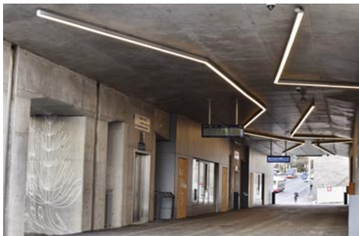
Osvětlení podchodu v nové železniční stanici Praha Zahradní Město.
