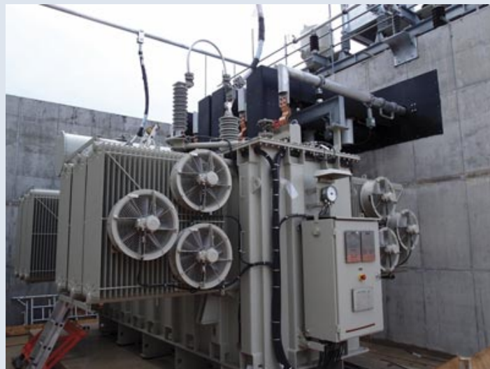
Výstupní transformátor vn/vn.
