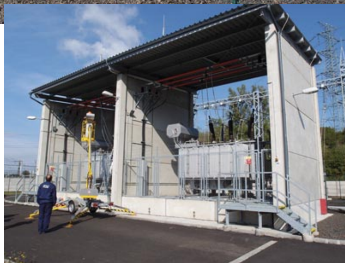
TNS Světec: rozvodna 110 kV a stanoviště transformátorů 110/23 kV.
