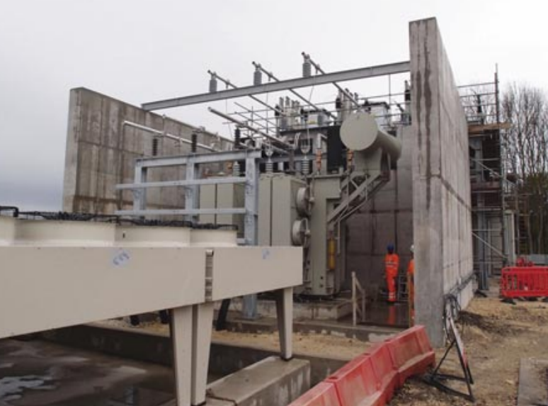
Vstupní transformátor vn/vn, 34 MVA (v popředí chladiče vodního hospodářství).
