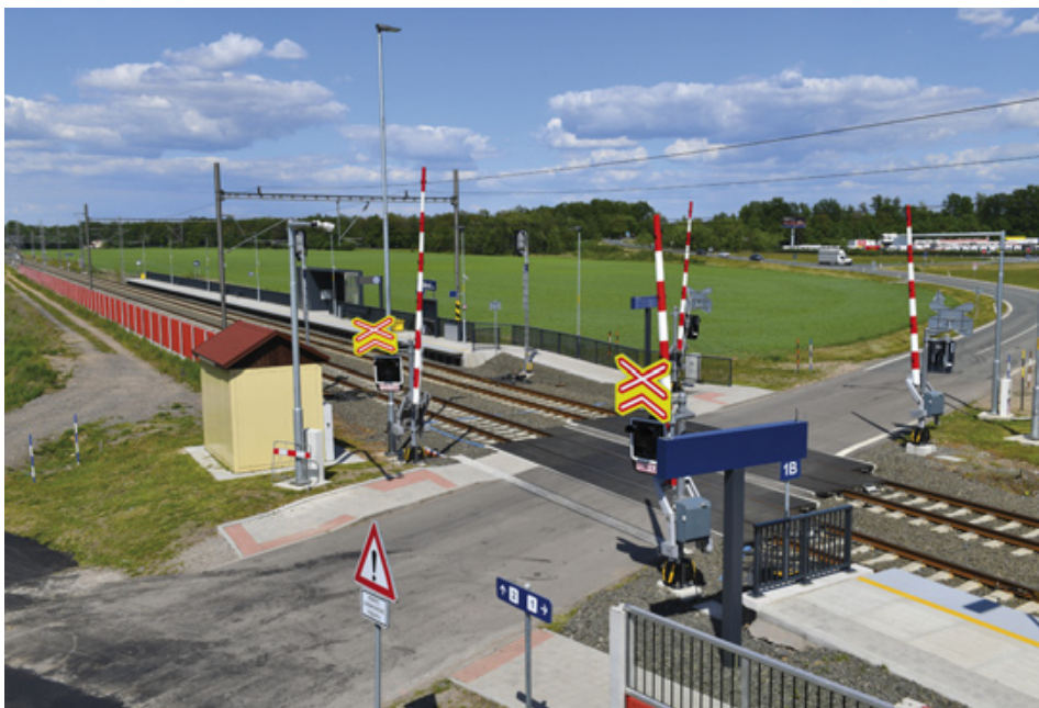
Zabezpečovací zařízení železničního přejezdu u zastávky Stéblová obec.
